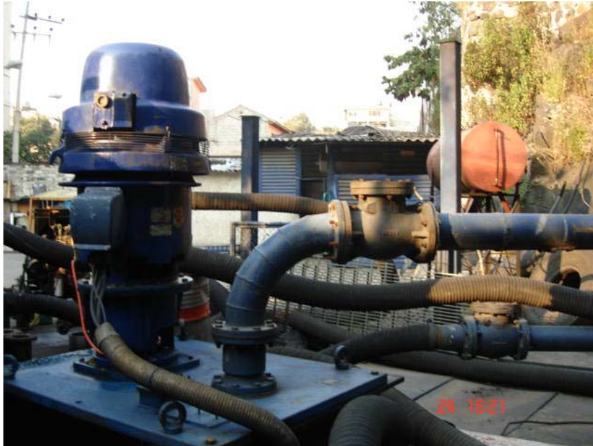
EQUIPO DE BOMBEO Y FONTANERIA DE DESCARGA DE AGUAS RESIDUALES, CARCAMO EL CARACOL
