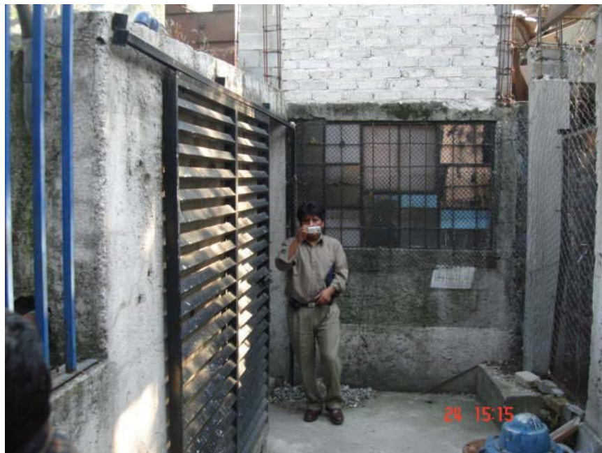
EXTERIOR DE BODEGAS DEL CARCAMO HUIHUITITLA, SE REQUIERE REMODELACION, SE OBSERVA CONSTRUCCION EN PLANTA ALTA
