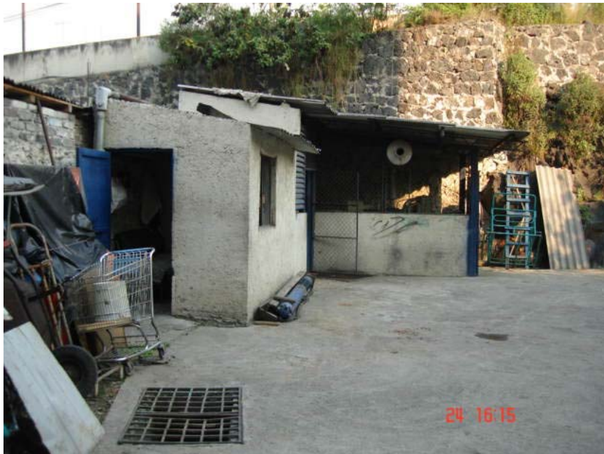
CASETA DEL OPERADOR Y DE CONTROL DE MOTORES, CARCAMO EL CARACOL (SE REHABILITARAN)
