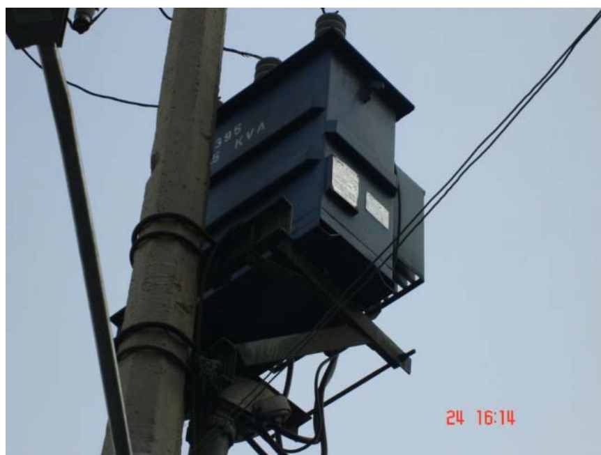
SUBESTACION ELECTRICA CARCAMO EL CARACOL
