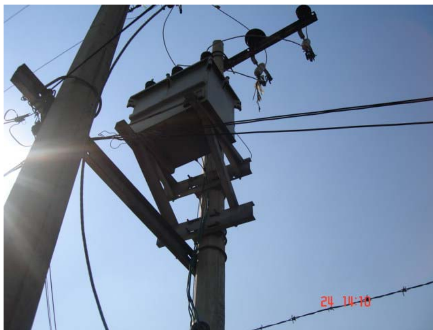
SUBESTACION ELECTRICA CARCAMO CUAUHEMOC
