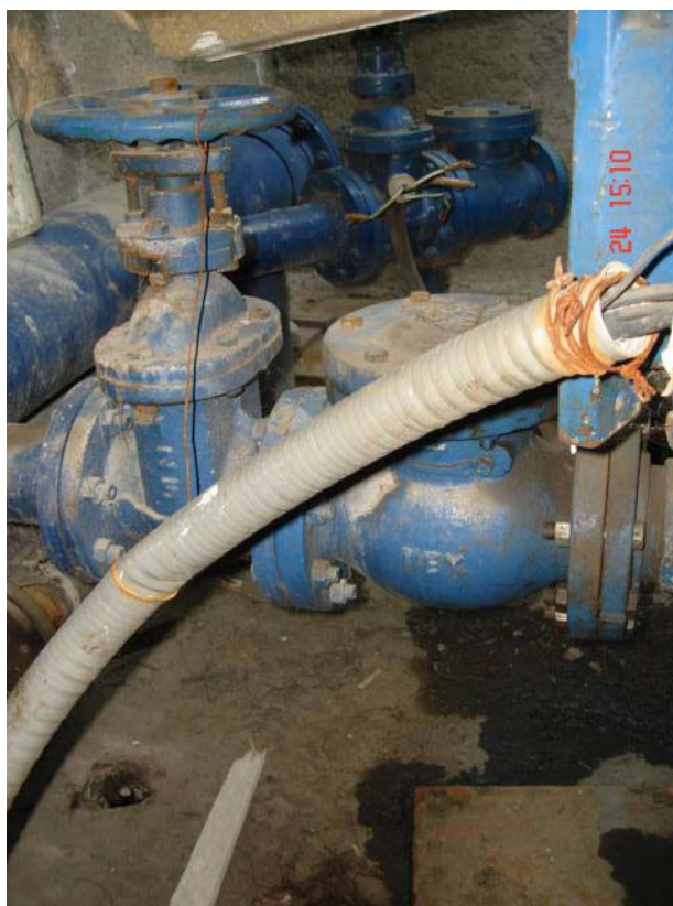
FONTANERIA DEL EQUIPO DE BOMBEO CARCAMO HUIHUITTLA
