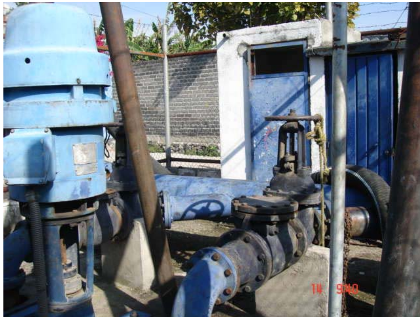
EQUIPO DE BOMBEO Y MULTIPLE DE DESCARGA Y CASSETAS DE CONTROL DE MOTORES CARCAMO CUAUHEMOC
