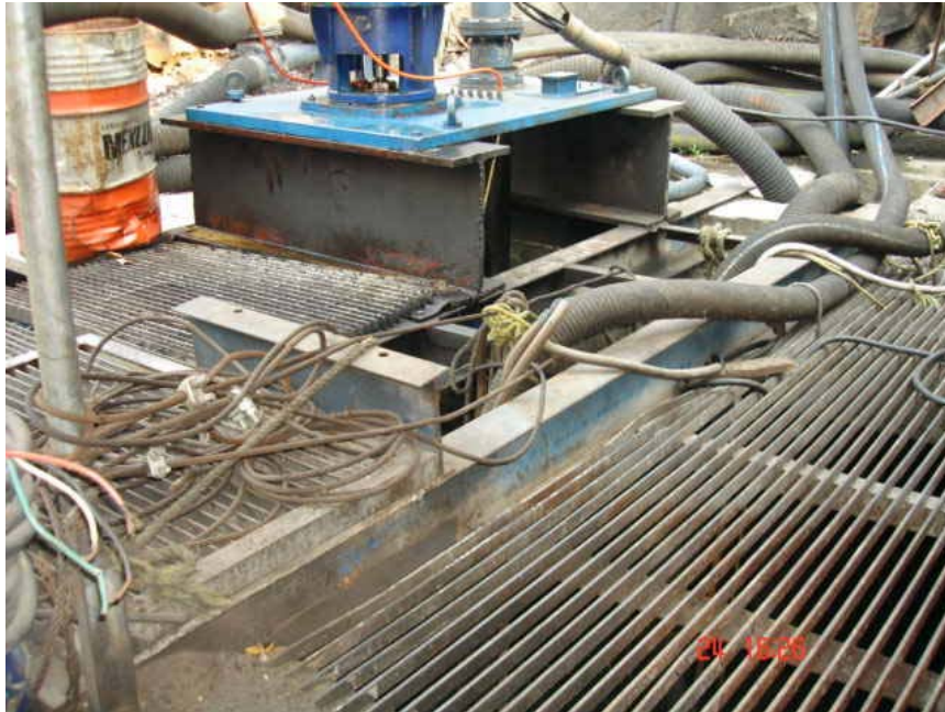
SE OBSERVAN INSTALACIONES PROVINCIONALES CON MANGUERAS Y CABLES DE USO RUDO EN EL CARCAMO DE BOMBEO EL CARACOL
