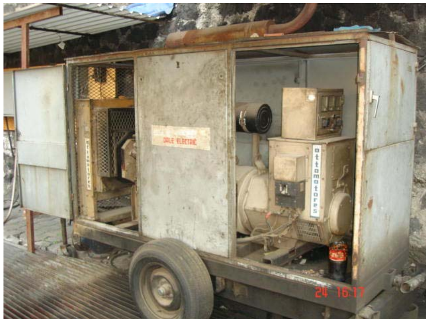
PLANTA GENERADORA DE ENERGIA ELECTRICA FUERA DE SERVICIO, CARCAMO EL CARACOL
