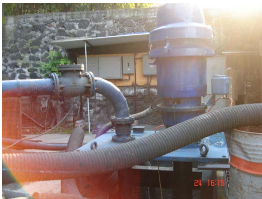
EQUIPO DE BOMBEO, AL FONDO SE APRECIA EL EQUIPO ELECTRICO DE CONTROL DE MOTORES, CARCAMO EL CARACOL
