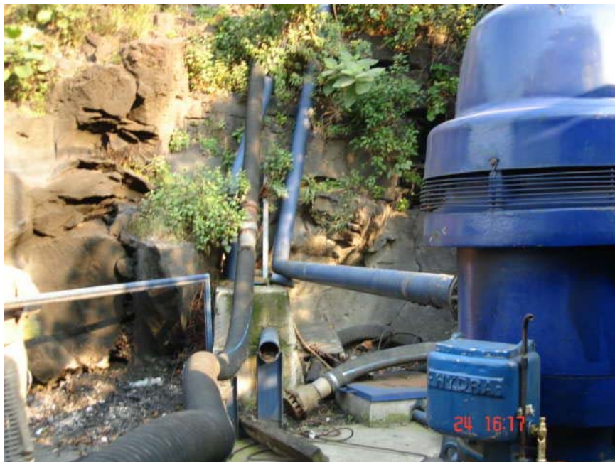
SE OBSERVAN LAS TRES LINEAS DE DESCARGA DE AGUAS RESIDUALES DEL CARCAMO DE BOMBEO EL CARACOL
