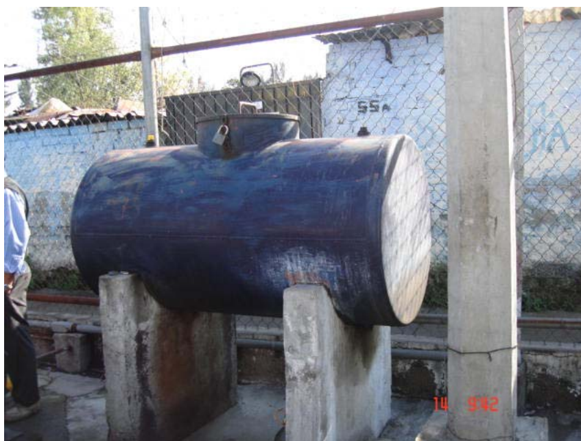
DEPOSITO PARA DIESEL CARCAMO CUAUHEMOC
