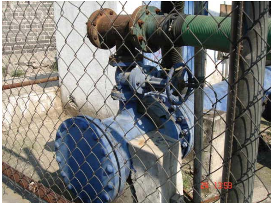
INSTALACION DE DESCARGA EN TERMINAL DE MULTIPLE DE DESCARGA DEL CARCAMO CUAUHEMOC
