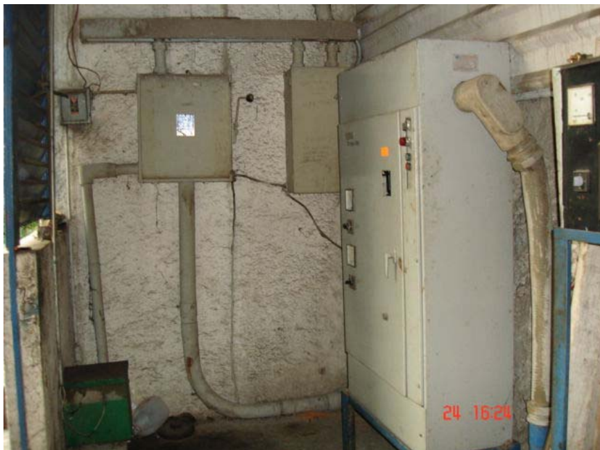
EQUIPO ELECTRICO, CARCAMO EL CARACOL
