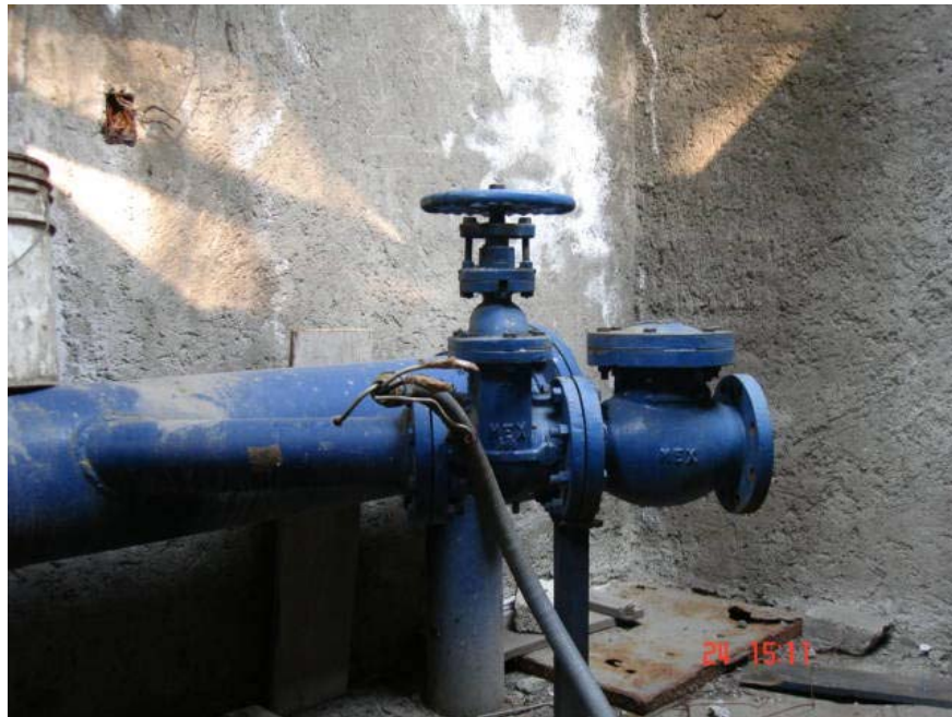
ARREGLO DE FONTANERIA FUERA DE SERVICIO FALTA EQUIPO DE BOMBEO CARCAMO HUIHUITTLA
