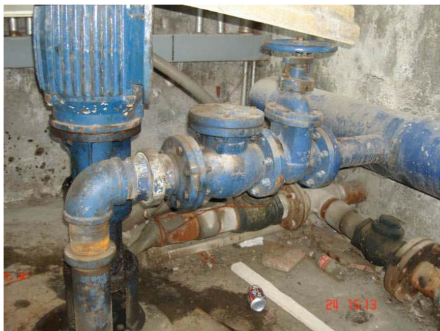
EQUIPO DE BOMBEO EN OPERACIÓN CARCAMO HUIHUITTLA
