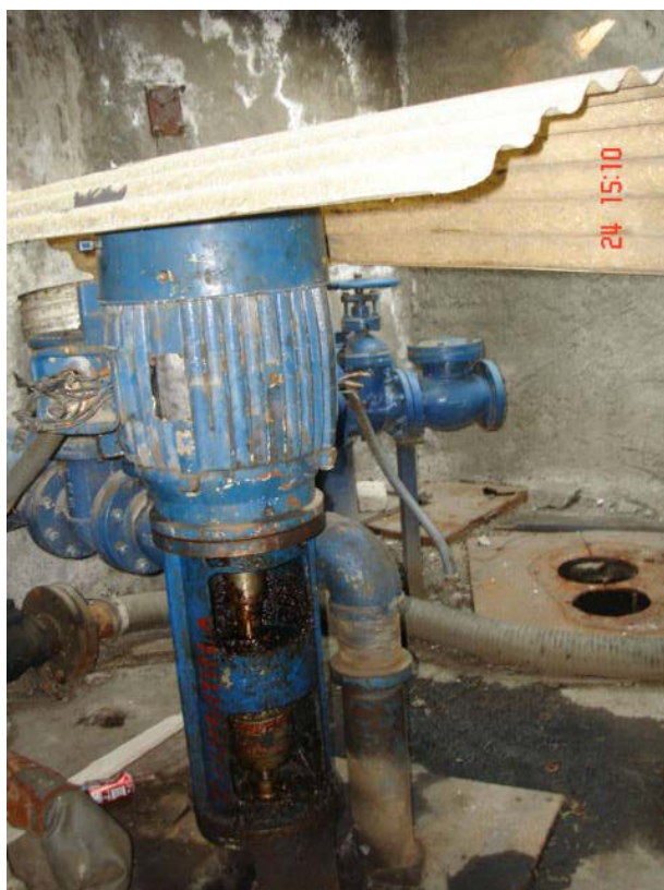
EQUIPO DE BOMBEO CARCAMO HUIHUITITLA
