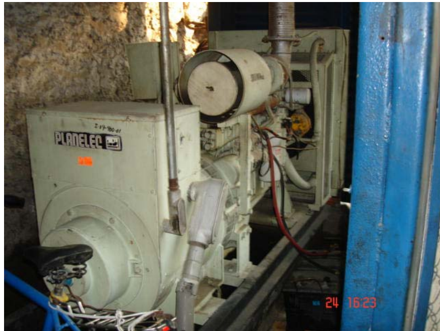
PLANTA GENERADORA DE ENERGIA ELECTRICA EN OPERACIÓN, CARCAMO EL CARACOL
