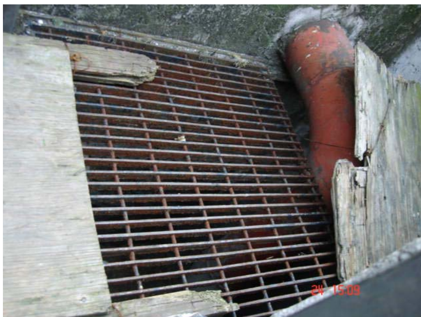
TAPA CON REJILLA EN ENTRADA DE AGUAS RESIDUALES DE CARCAMO HUIHUITITLA
