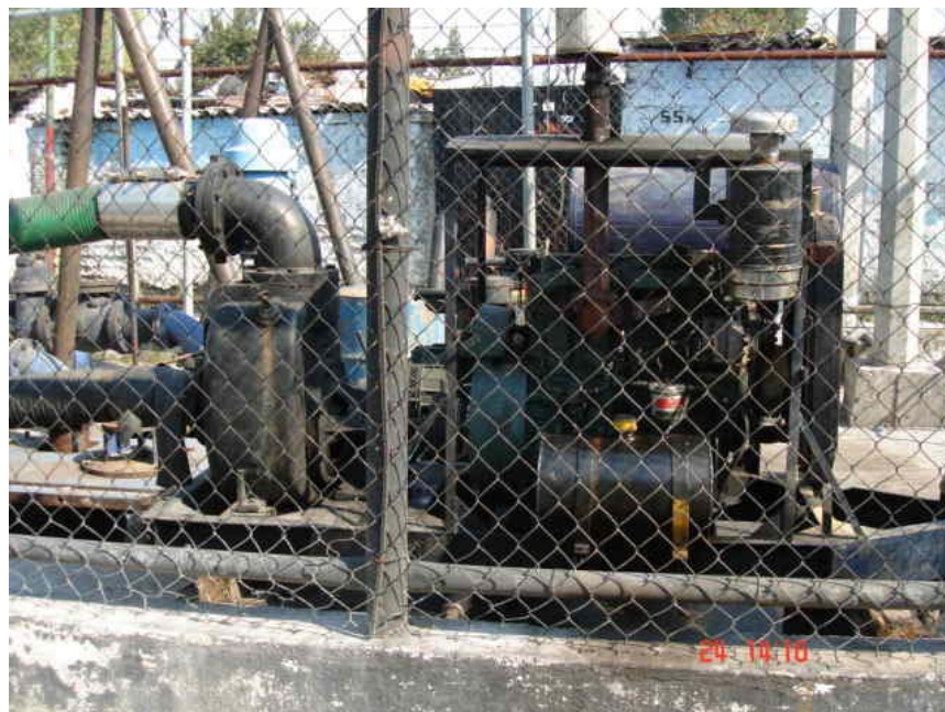
MOTOR DE COMBUSTION INTERNA EN FUNCIONAMIENTO CARCAMO CUAUHEMOC
