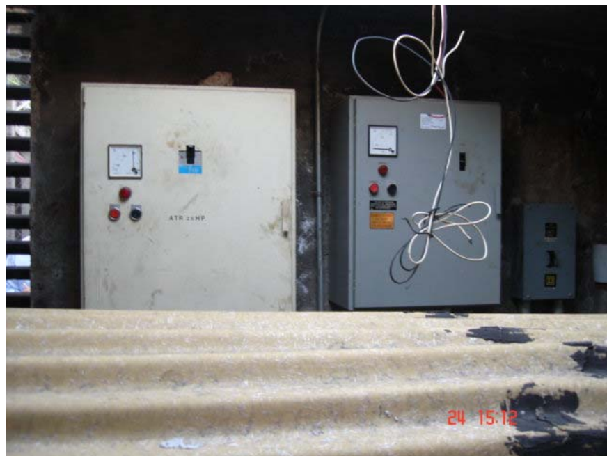
EQUIPO ELECTRICO DE CONTROL DE MOTORES CARCAMO HUIHUITTLA
